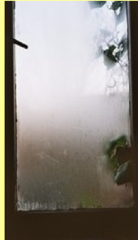
Fenster beschlagen mit Wasserdampf
